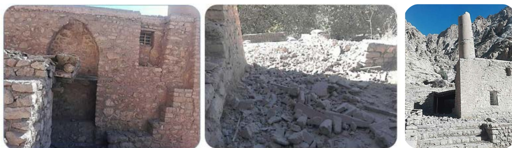
تصویر ۸: مسجد عبدالله بن عمر بعد از زلزله (از کتاب: زلزله کرمانشاه؛ آسیب‌شناسی و درس آموخته‌ها، ۱۳۹۷).
