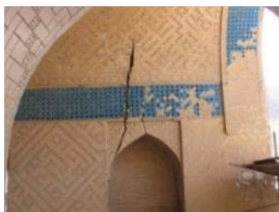
تصویر ۱۷: ترک عمیق در بخش فوقانی نمای داخلی جبهه شرقی (نگارندگان، ۱۳۹۵). Fig. 17: A Deep Crack in the Upper Part of the Inner East Elevation (Authors, 2016).
