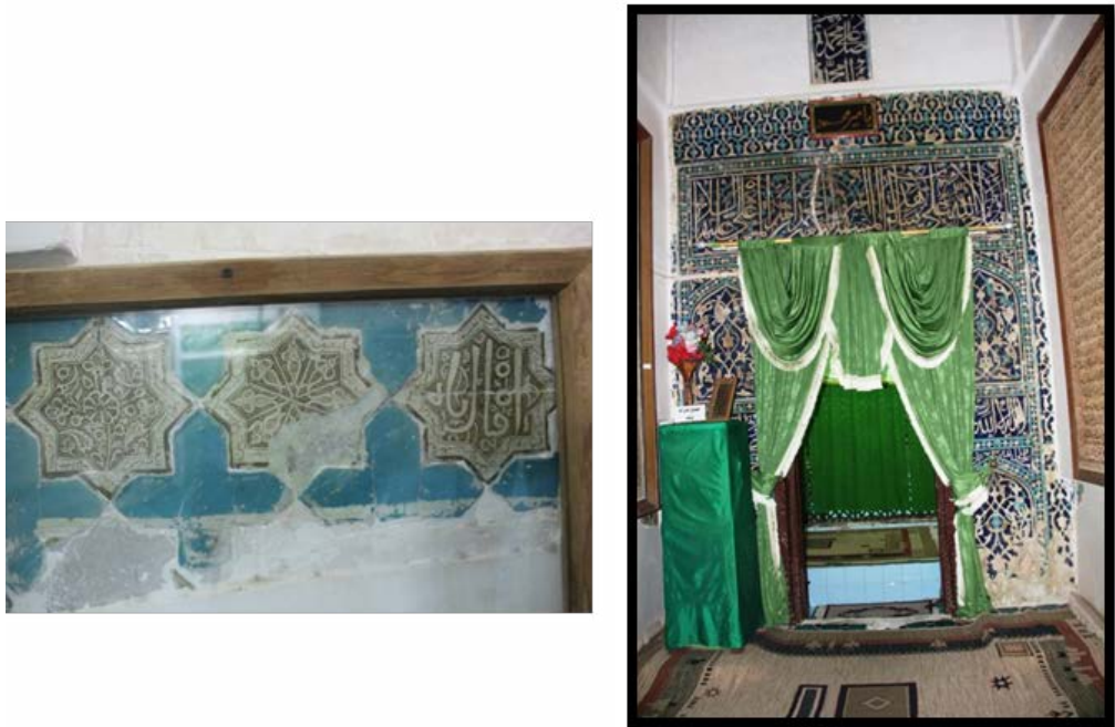
تصویر ۴: کاشی‌های معرق آبی سفید ورودی جنوبی و کاشی‌های زرین فام ازاره گنبدخانه میرمحمد حنفی (نگارندگان، ۱۳۹۴). Fig. 4: Blue and white mosaic-faience tileworks of south entrance and lustre tiles of dado in the dome chamber of Mir Muhammad Hanafi (Authors, 2015).
