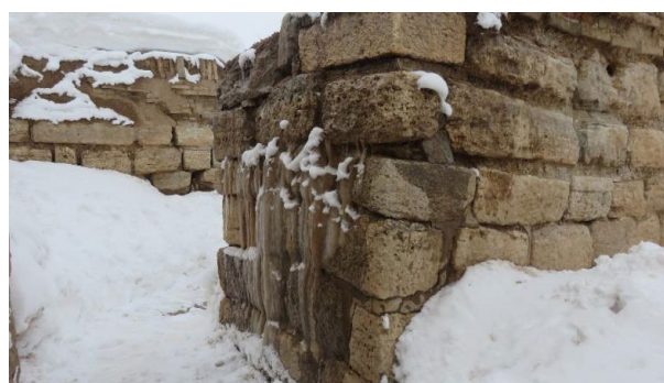
شکل ۱۳. از بالا به پایین تصاویری از یخ‌بندان و هوازگی سنگ‌ها ناشی از نزولات جوی بر روی دیوارها (عوارض این مشکلات شامل تورم و پوسته‌شدن سنگ‌ها)، (عکس‌ها از آرشیو پایگاه تخت سلیمان)
