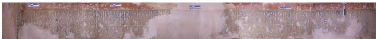
شکل ۱۴. کتیبه گچبری جبهه جنوبی مسجد آق قلعه نقاب سبزوار (عکس از نگارنده)
