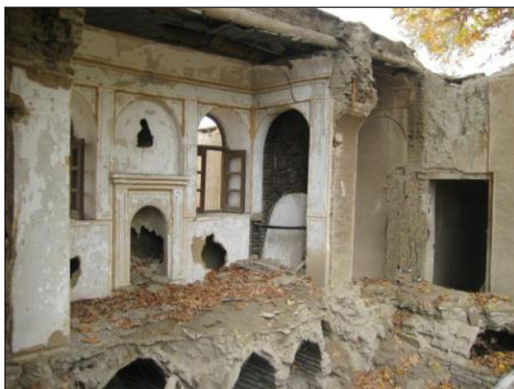
تصویر ۶. نمای از اتاق سه دری شمالی که تخریب شده است (عکس از: نویسندگان).
