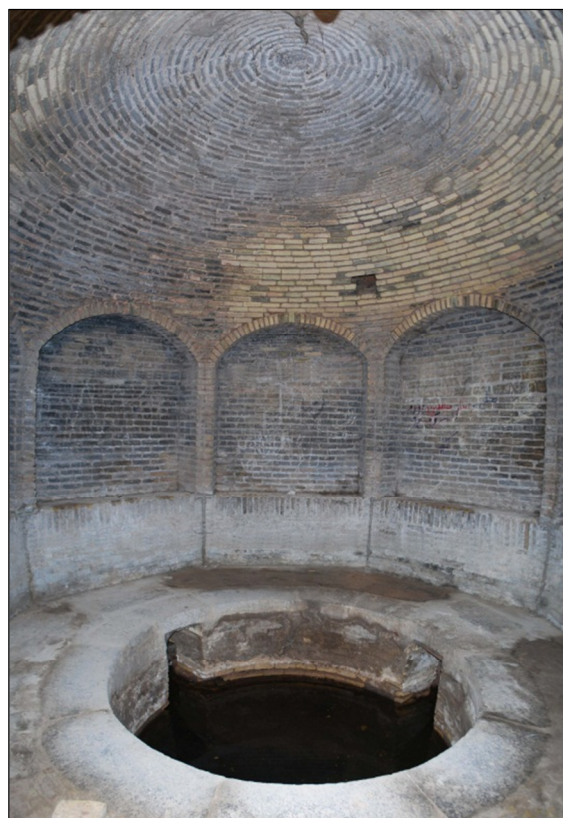
تصویر ۴. پایاب قنات زارچ در مسجد جامع یزد مذکور در وقف‌نامه (مأخذ: ابراهیم کاظم نژاد).
