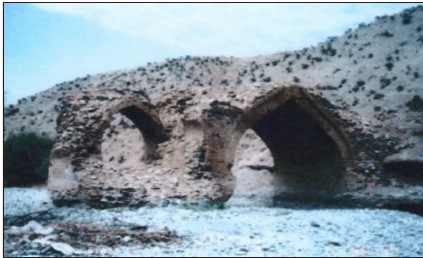
تصویر ۳. نمای شمالی پل بانوصحرا (مأخذ: آرشیو میراث فرهنگی استان تهران، بهار ۱۳۸۳).
