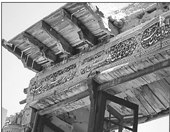
تصویر ۱۳. همان نما در دیوار پیشانی شمالی در سال ۱۳۹۱ که سر ستون مقرنس و بخشی از کتیبه‌ها تخریب شده است (مأخذ: فرشته سمنگویی).
