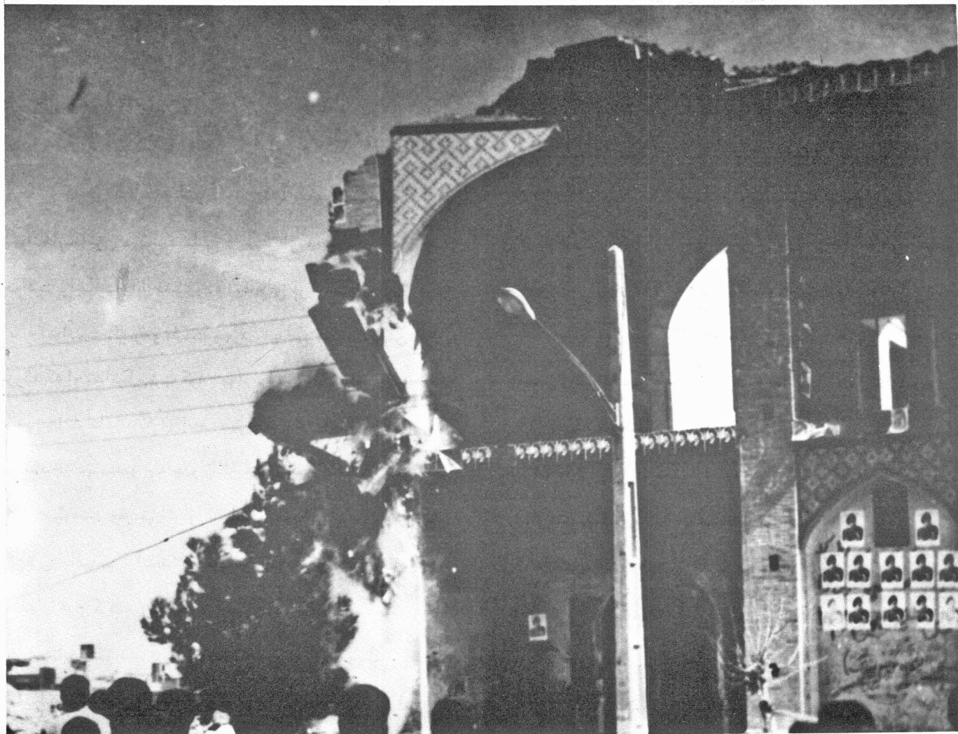
دیوانخانه در حال تخریب
