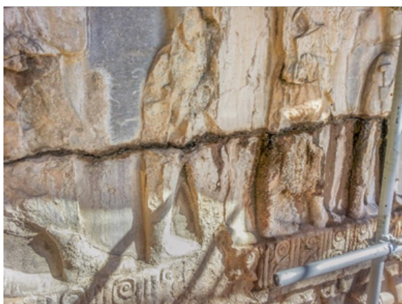
شکل ۴. شکستگی‌های ایجاد شده بر روی آرامگاه خشیارشا
